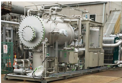
100kW级双工质发电实证测试机※(本公司京滨事业所内)
